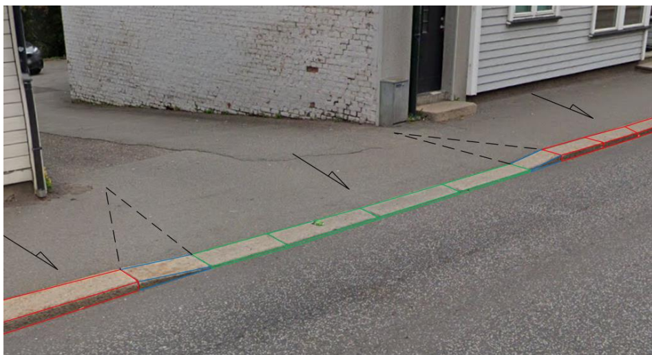
Figur 32 Viser nedsenket kantstein
